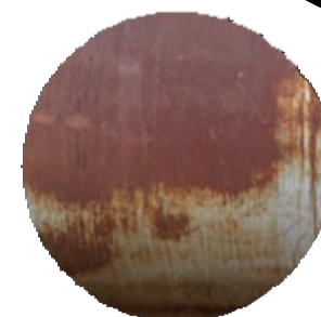
Spremnici od čelika korodiraju s prolaskom vremena
